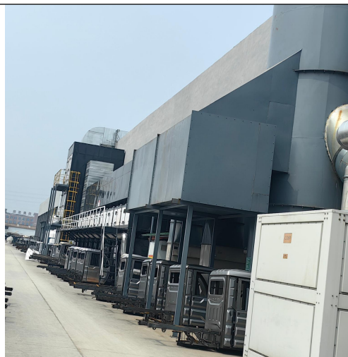
过滤棉+活性炭吸附/脱附+催化燃烧装置
