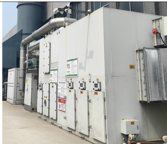
过滤棉+沸石转轮浓缩+CO 焚烧装置
