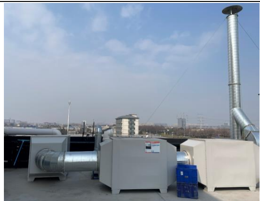
熔化、喷带工序废气处理设施及排气筒 DA003
