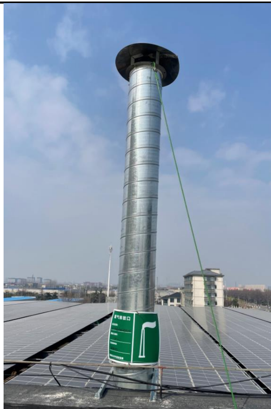
DA002 废气标识牌
