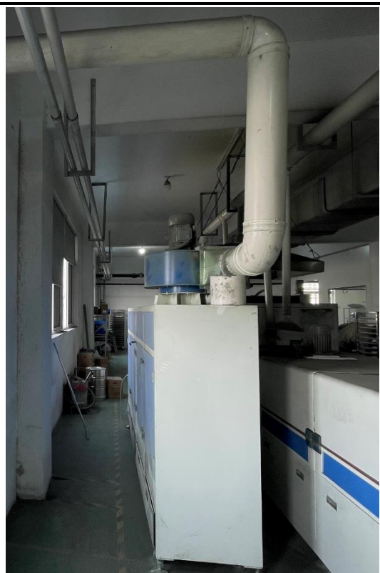
喷涂工序废气处理设置
