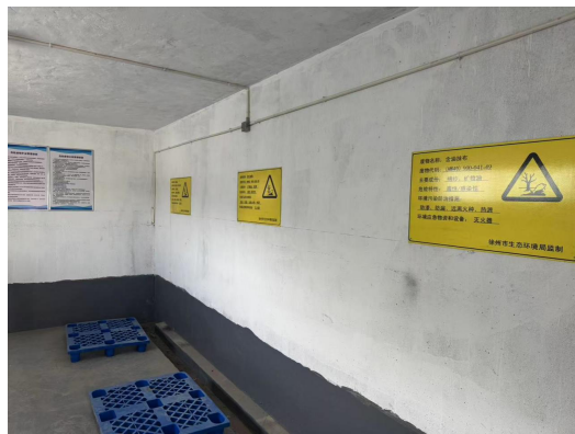
危废库内部分类储存标识牌
