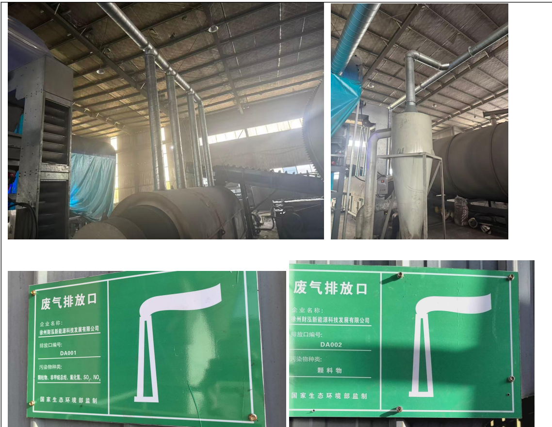
图 3.1-6 废气处理设施及排气筒
