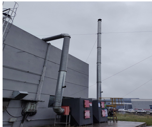
危废库排气筒 DA004
