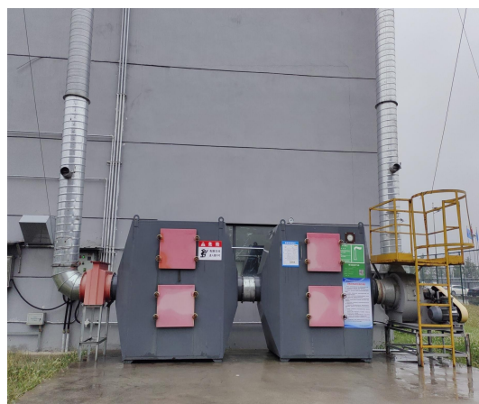
危废库二级活性炭吸附装置及标识牌
