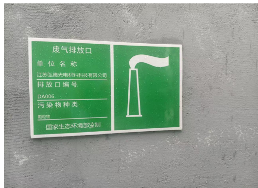
喷砂密闭收集管道、布袋除尘器及标识牌
