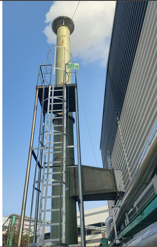
沼气锅炉废气排气筒 (DA009)
