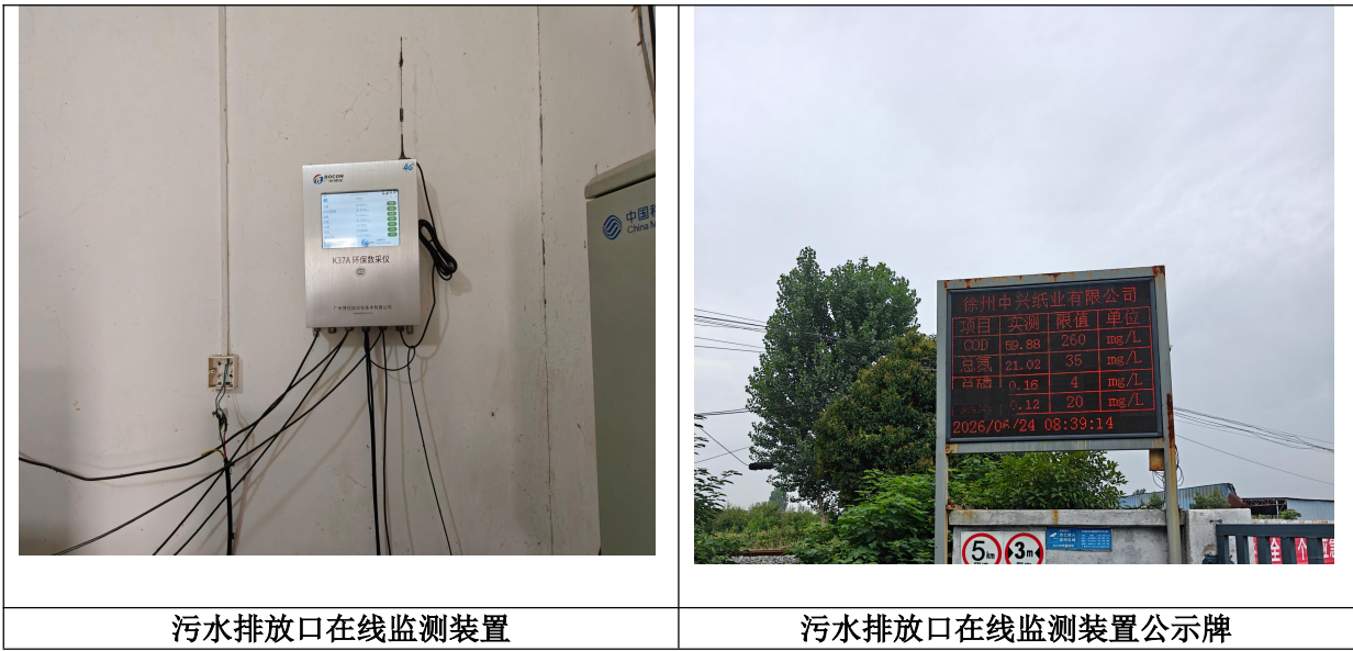
图 4.1-9 厂区污水排放口标识牌及在线监测装置
