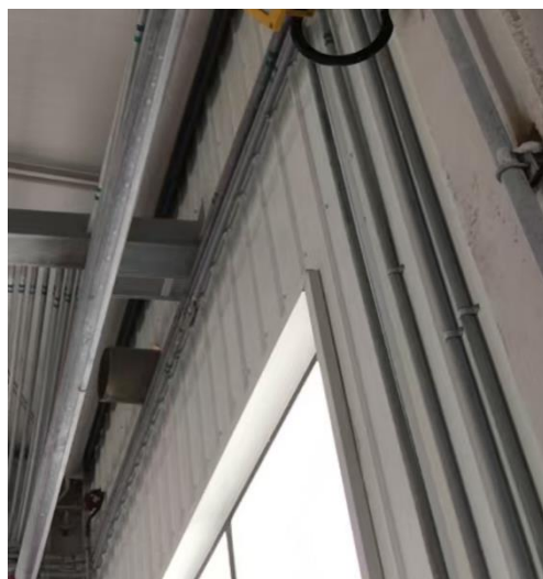
危废暂存间废气收集
