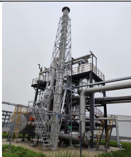
投料、搅拌、罐装、洗釜、润桶、储罐呼吸、 危废间废气处理设施及排气筒 DA001
