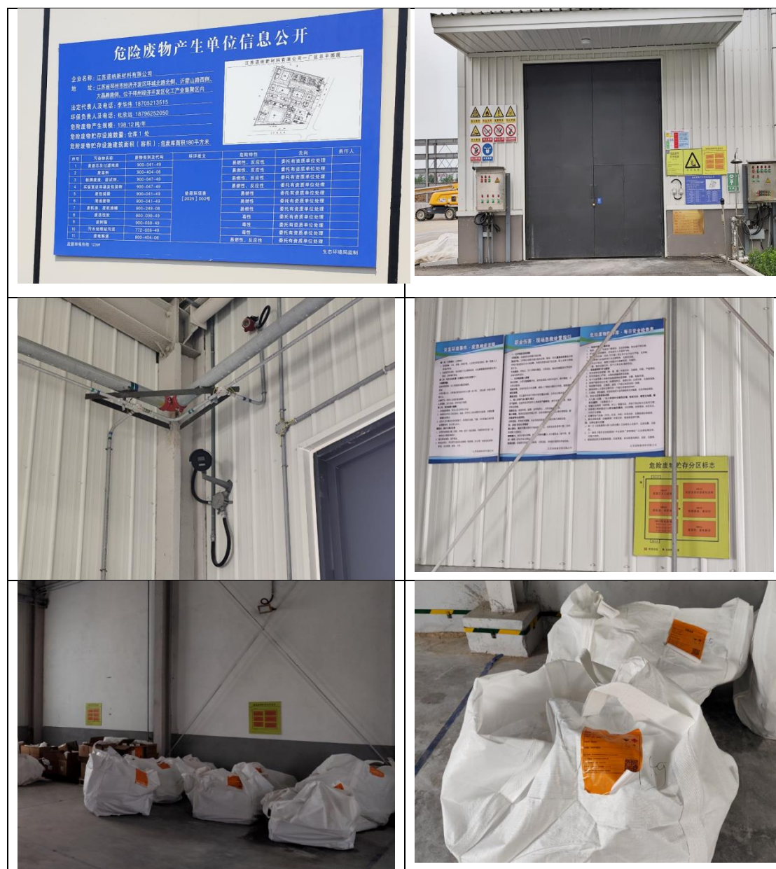
图 3-5 危废暂存间设置及相关标识牌设置情况
