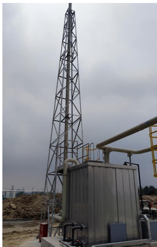
污水处理站废气处理设施及排气筒 DA003
