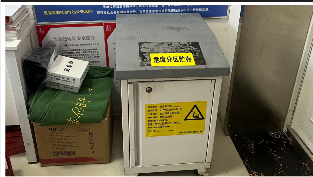
站房内放置废含油抹布收储柜
