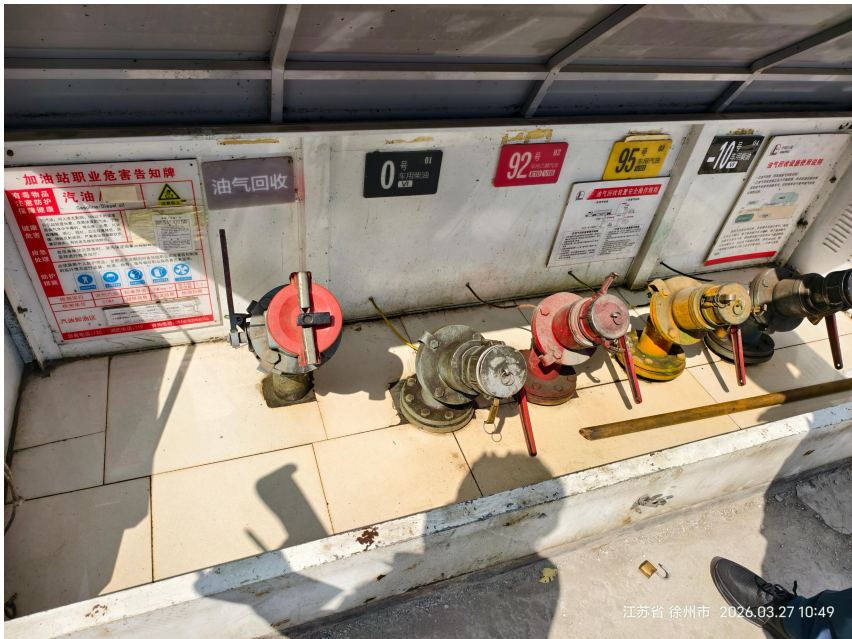
油气回收装置
