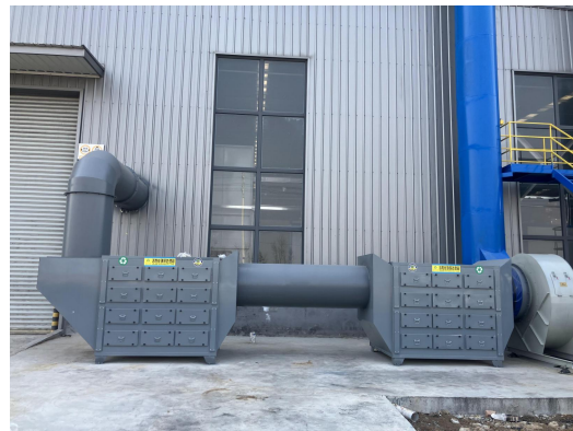
过滤棉+二级活性炭吸附装置
