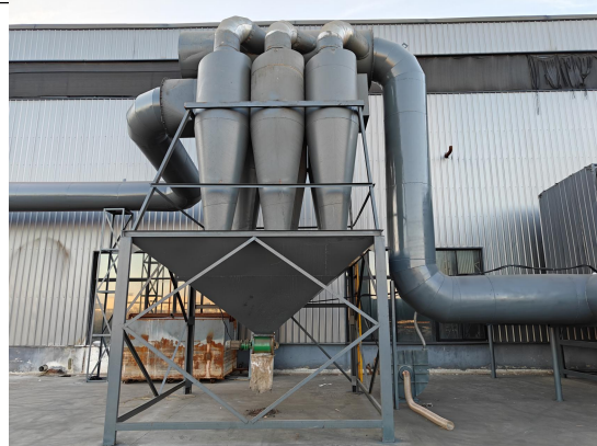
生物质锅炉配套多管除尘器
