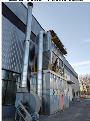
1#车间砂光、锯边布袋除尘器及 排气筒 DA006
