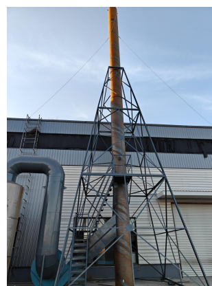
生物质锅炉配套排气筒 DA008
