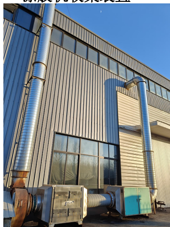
1#车间过滤棉+活性炭吸附装置 及排气筒 DA001
