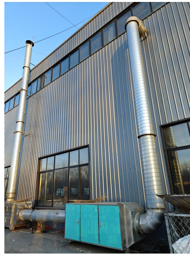
4#车间过滤棉+活性炭吸附装置 及排气筒 DA005
