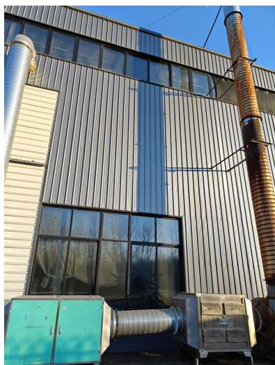
1#车间过滤棉+活性炭吸附装置 及排气筒 DA002
