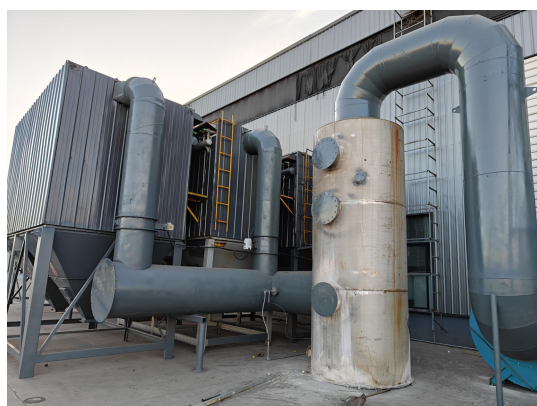
生物质锅炉配套 SDS 干法脱硫 +SCR 脱硝装置
