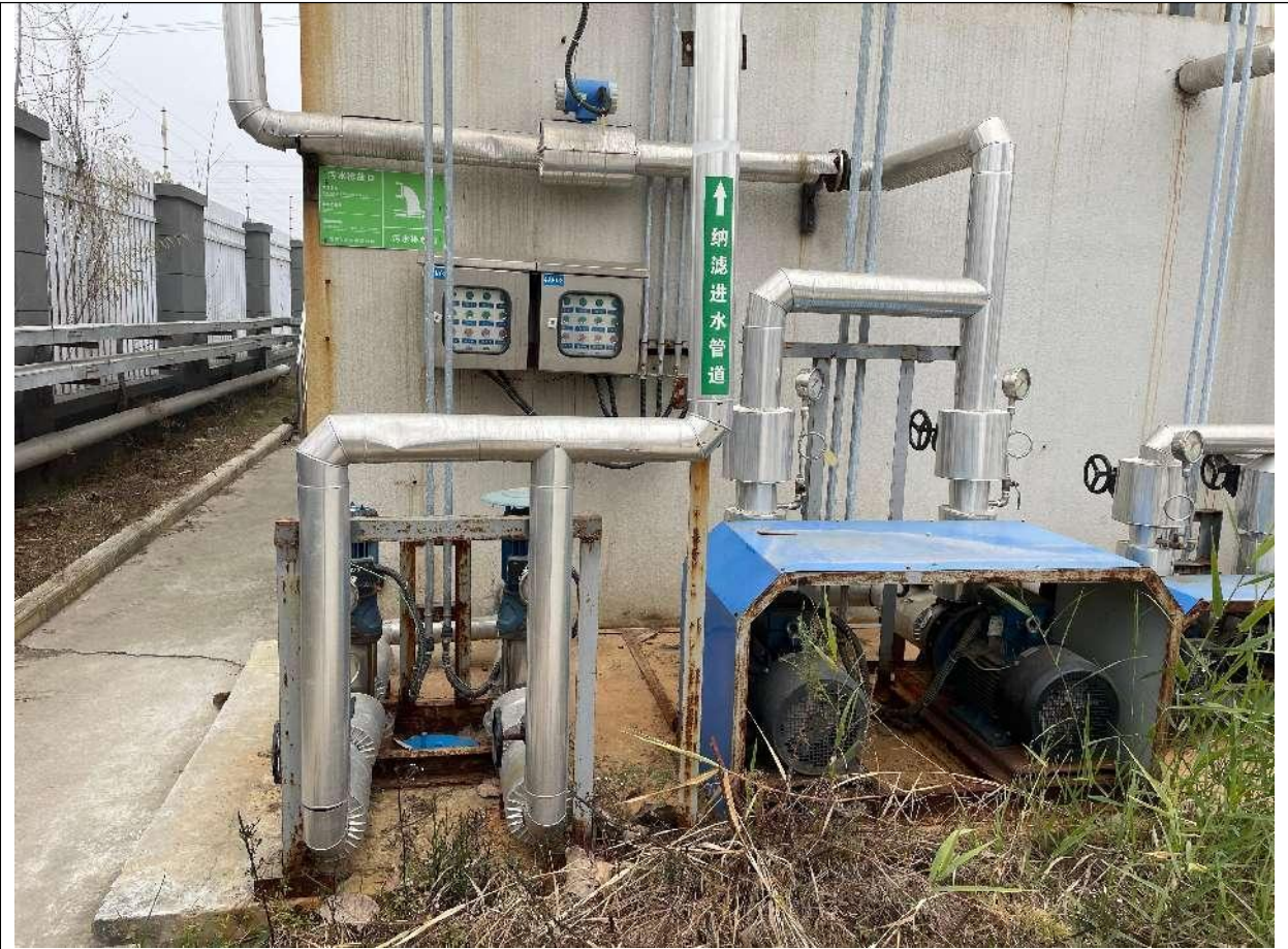
依托徐州绿源中天固废处置有限公司厂区污水处理站排口情况现场照片
