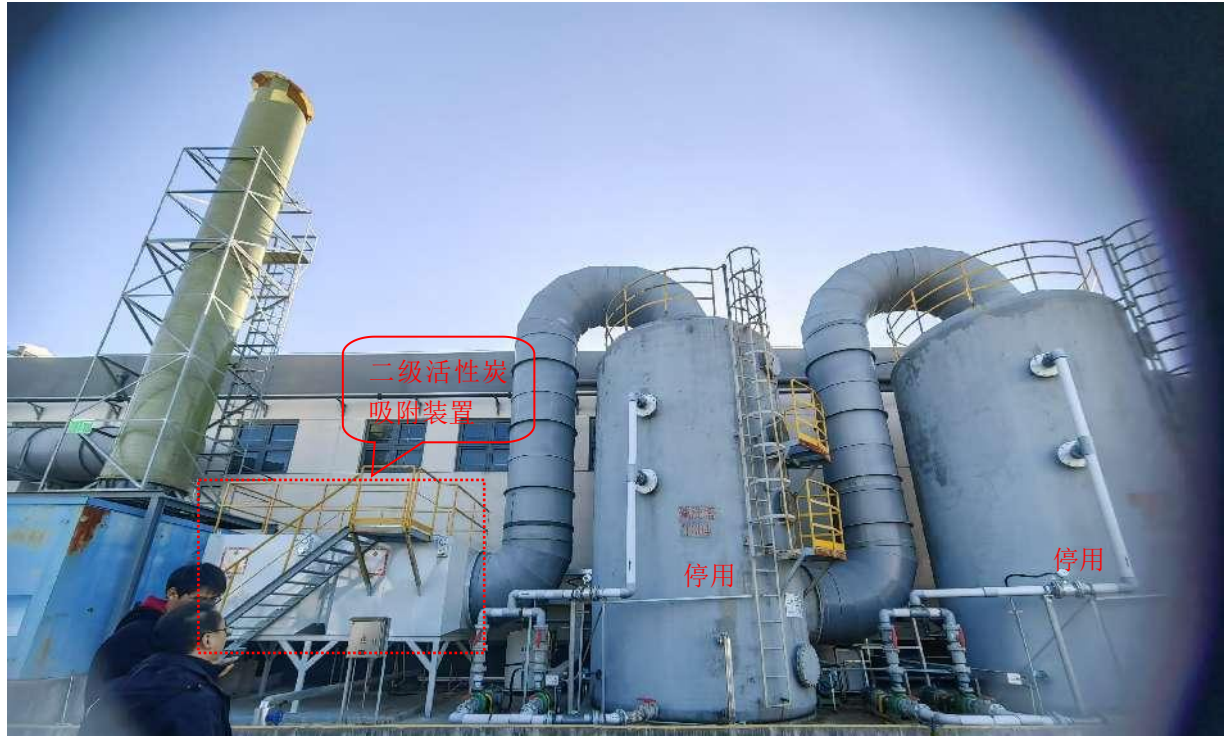
危废暂存间废气处理设施图
