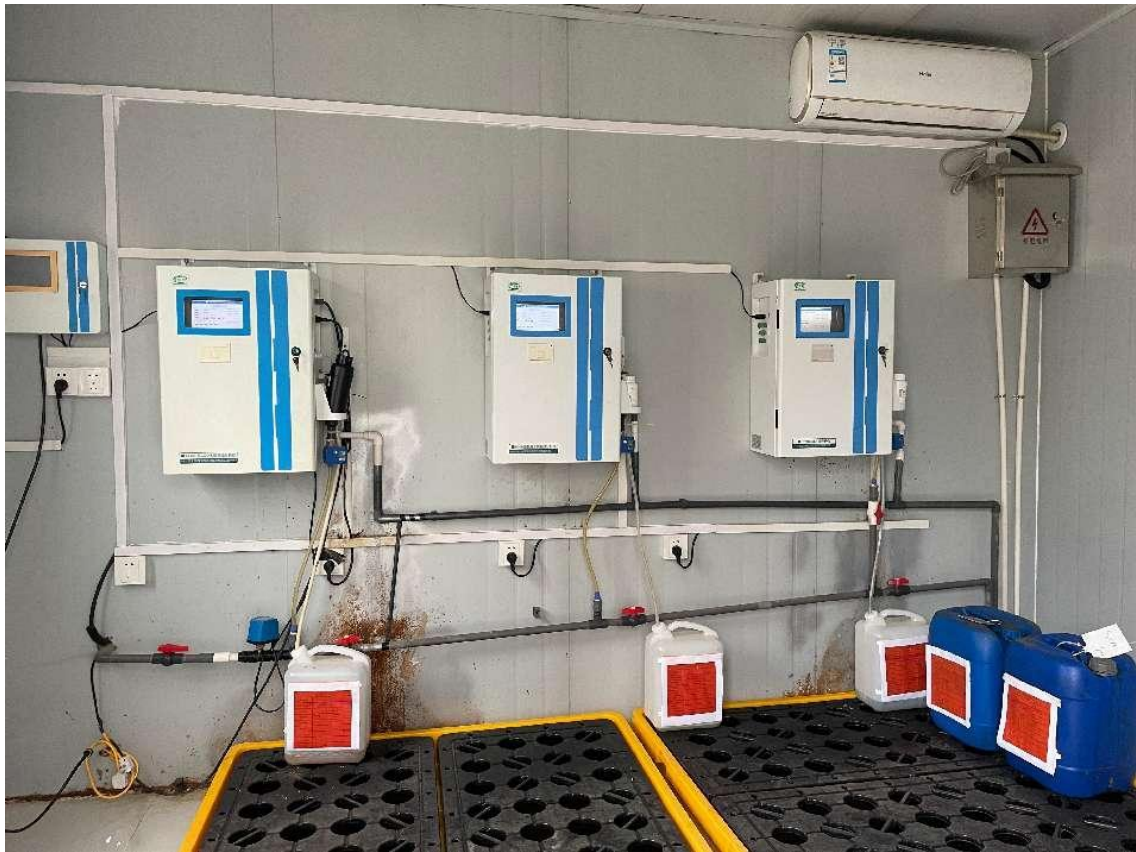
依托徐州绿源中天固废处置有限公司厂区污水处理站在线监测室现场照片
