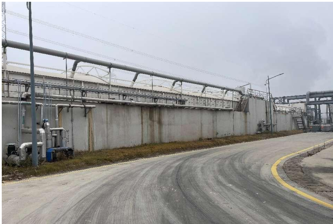
依托徐州绿源中天固废处置有限公司厂区污水处理站现场照片
